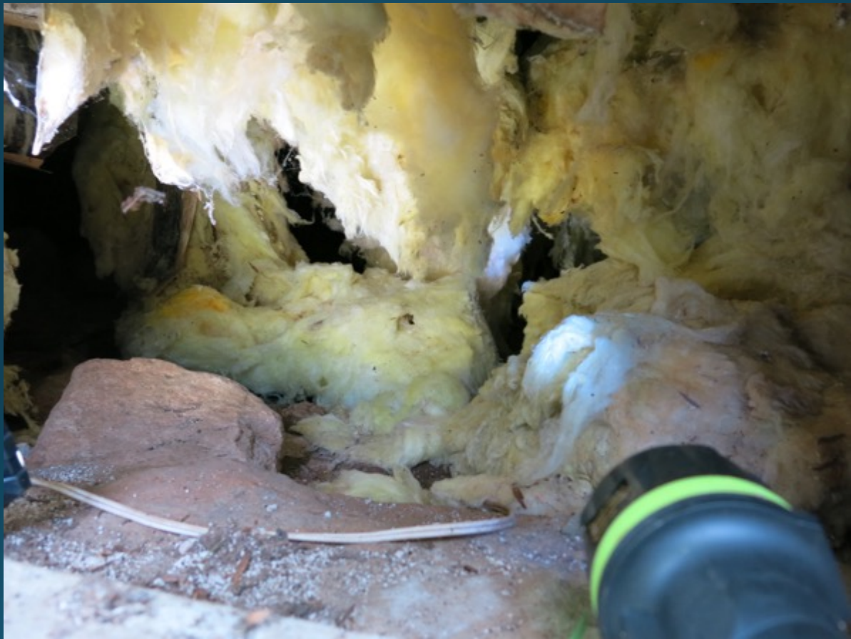
”Insulated” crawlspace ceiling
